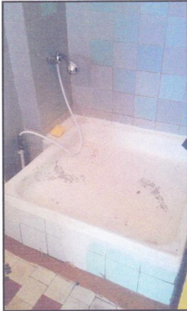
Фото № 12 «Душевая комната (поддон)»
