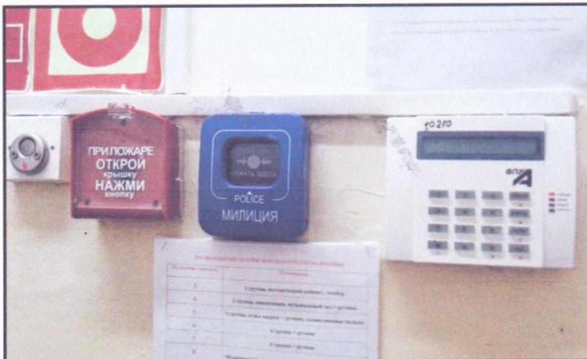
Фото № 13 «Охранно-пожарная сигнализация системы звукового оповещения о пожаре»
